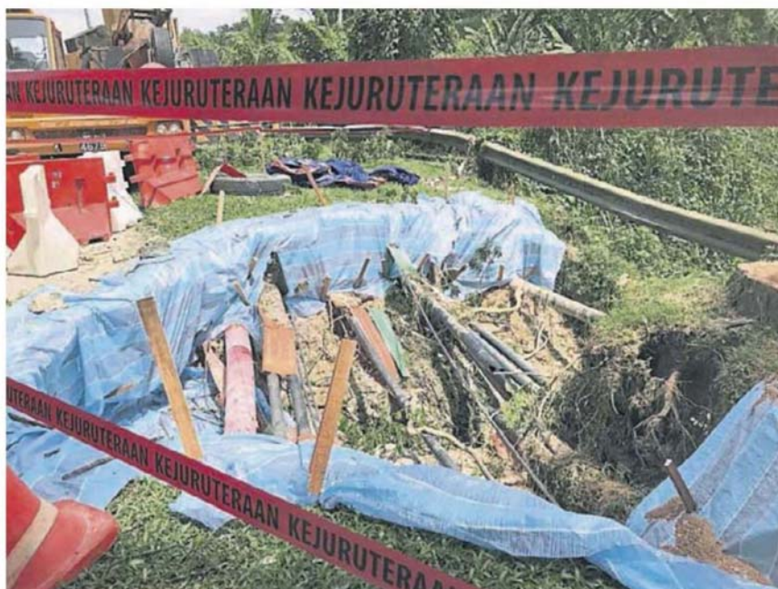
■路肩發生土崩後，許多地下電纜露了出來。
